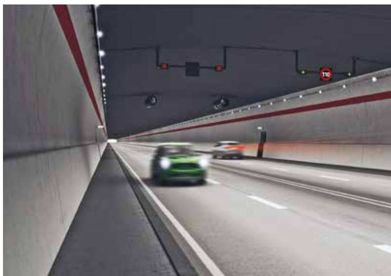
5. Il sistema di illuminazione permanente
